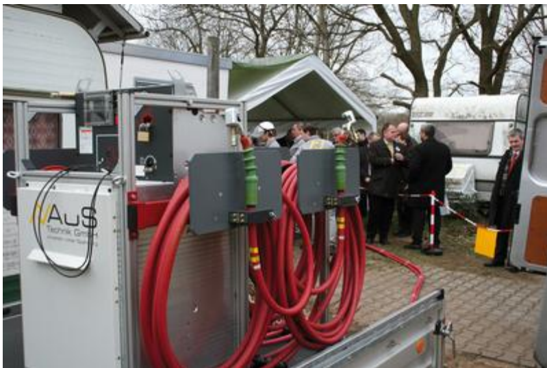
Bild: "Vorführung Mobile Überbrückungseinheit (MÜE) (Stadtwerke Dreieich):"
