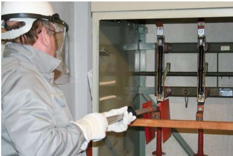
Bild: "Vorführung MÜE (Stadtwerke Dreieich): Abschottung"
